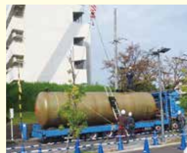
燃料貯蔵タンク
